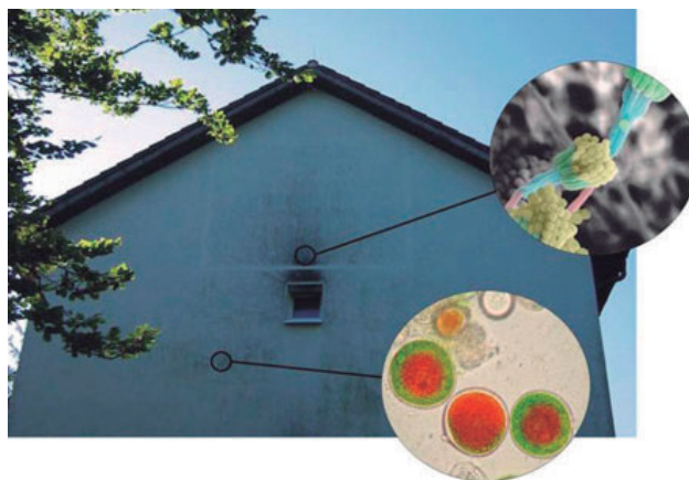
Figura 10.1. : Crecimiento de algas en fachada con sistema de aislación ETICS y crecimientos de hongos sobre ventana
