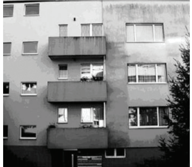
Figura 10.2. : Vista de edificio, cuyo sector derecho ha contado con aislacion termica por cerca de 1 año.
